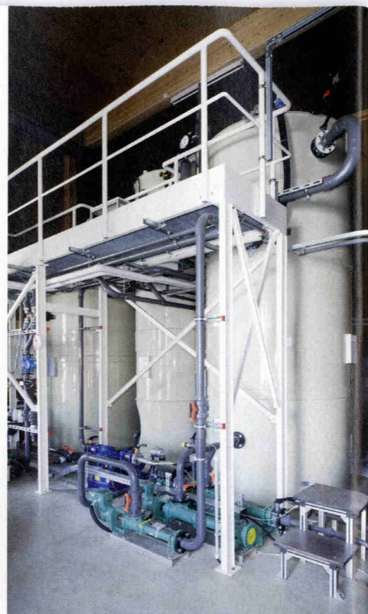
In diesen Behältern erfolgt die Reinigung der Abwässer
