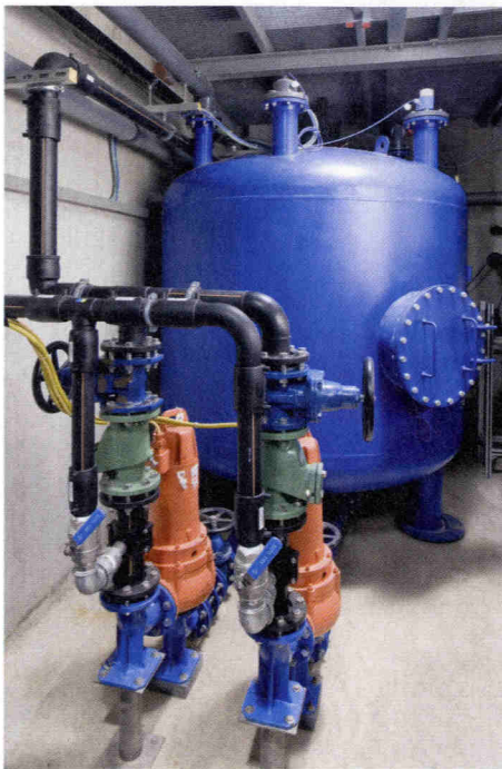
Über ein Vakuumsystem werden Küchenabfälle und Toilettenabwässer aus einigen Häusern des Neubaugebietes in Knittlingen abgesaugt.
