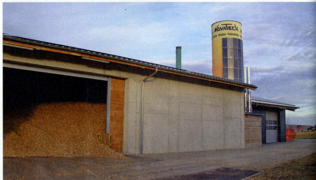
Die Hackschnitzelheizanlage versorgt Gewerbebetriebe, die Kommune und Privatleute in Wolpertshausen.
